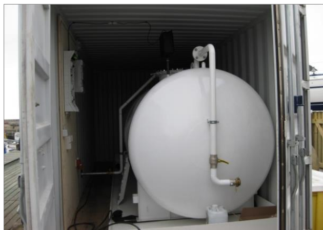
Tank på 10 m 3 inkl. spildbakke opstillet i 20' skibscontainer.
