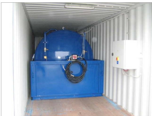
Tank på 25 m 3 inkl. stor spildbakke opstillet i 40' skibscontainer.
