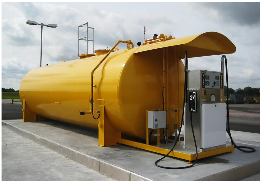
Tankanlæg til diesel med en 40 m 3 dobbeltvægget tank.
