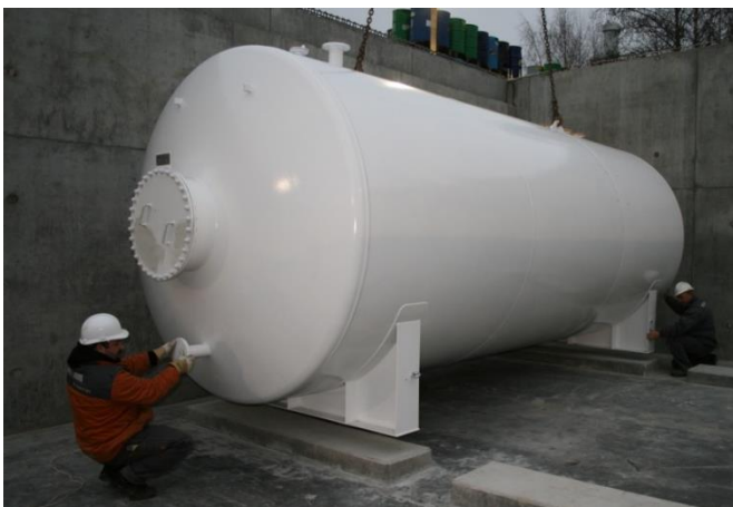
30 m 3 enkelmantlad cistern med diametern 2,5 meter
