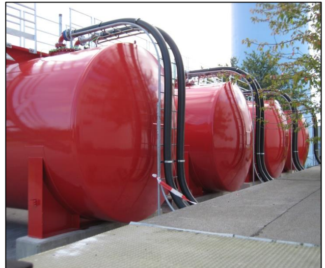
4 x 100 m 3 dubbelmantlade cisterner med gångväg
