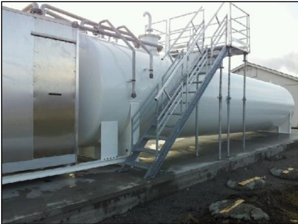
60 m 3 dubbelmantlad cistern för flygbränsle
