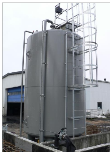
Vertikal tank på 100 m 3 diameter 2900 mm. Tanken er forsynet med 200 mm isolering og dækplade.
