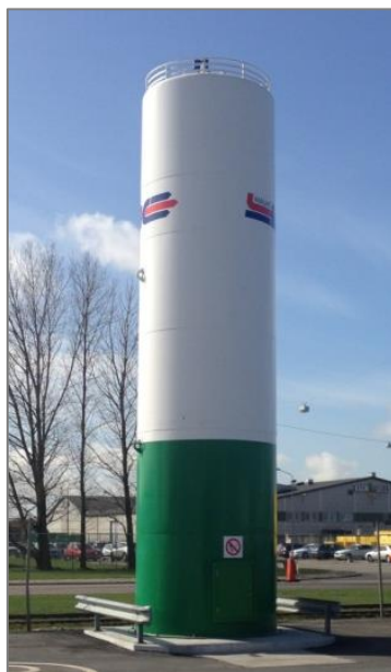
Vertikal tank på 60 m 3 diameter 2900 mm. Udført med rum under selve tanken inkl. adgangsdør.
