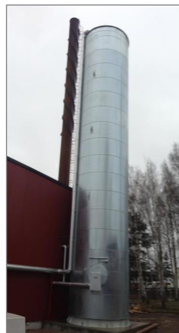
20 m 3 vertikal tank diameter på 2500 mm. Udført med stige og platform, nedført påfyldning, nedført sugerør, lækageovervågning m.m.
