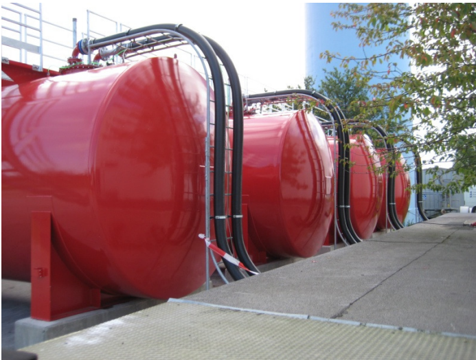
4 x 100 m 3 dobbeltvægede tanke med gangbro
