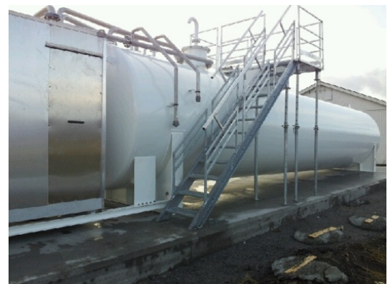
60 m 3 dobbeltvægget tank til flybrændstof
