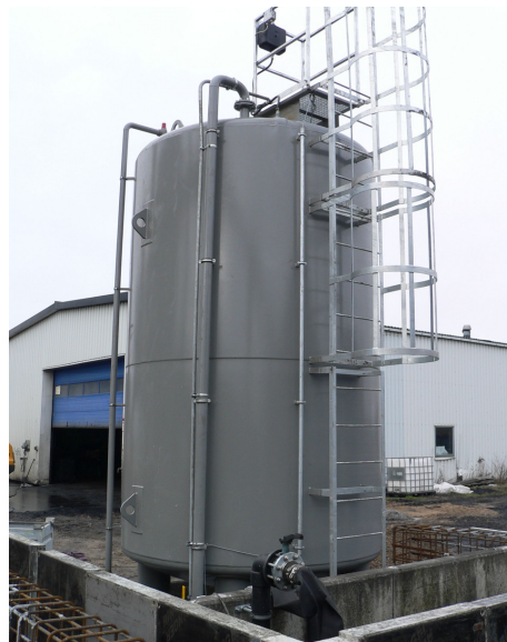
20 m 3 vertikal tank med en diameter på 2500 mm. Udført med stige og platform, nedført påfyldning, nedført sugerør, lækageovervågning m.m.
