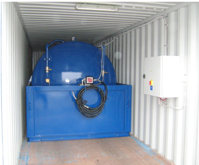
Tank på 25 m 3 inkl. stor spildbakke opstillet i 40' skibscontainer.
