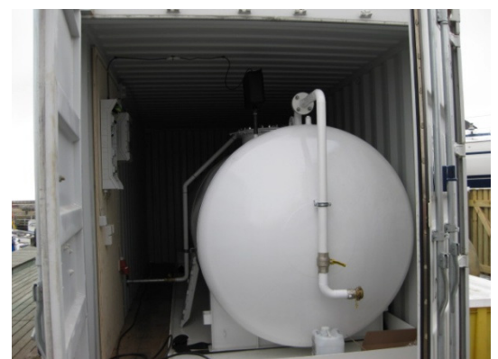
Tank på 10 m 3 inkl. spildbakke opstillet i 20' skibscontainer.
